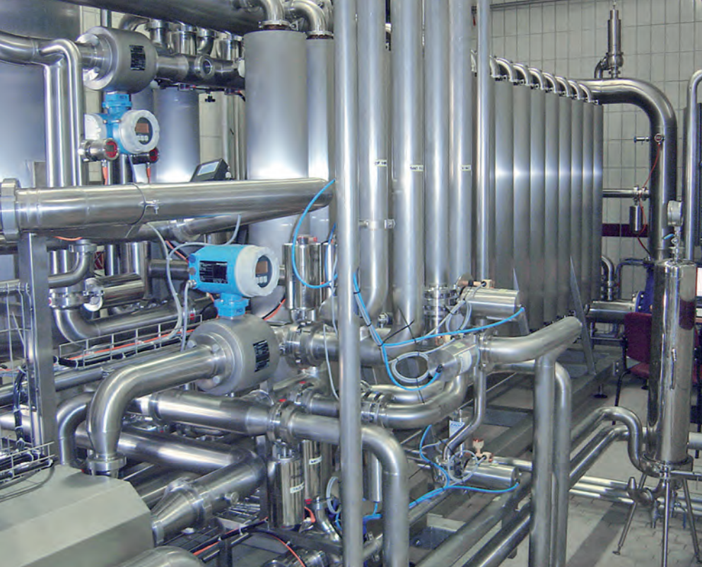
Pall Oenoflow XL 30-A HP Crossflow-Anlage bei der Rotkäppchen-Mumm Sektellerei
