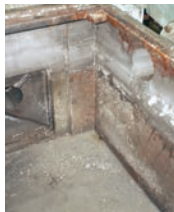
Corrosion dans le réservoir
