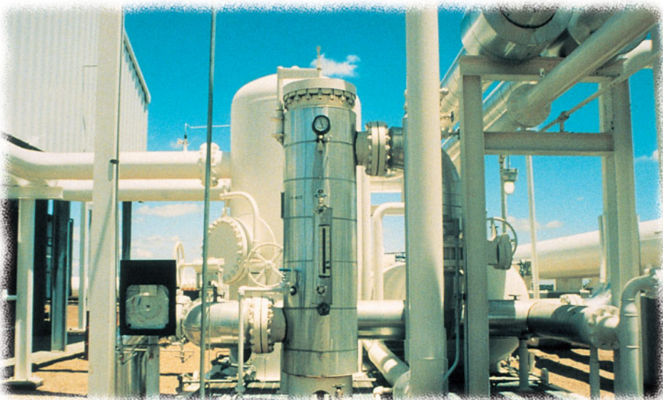
水素コンプレッサーの保護に“LG コアレッサー”が設置された例
