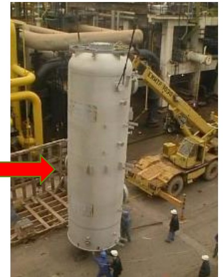
Pall気/液コアレッサー を設置
