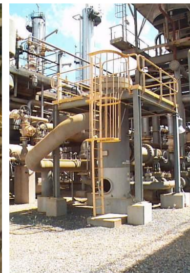
吸着塔後段に定格ろ過 精度フィルターを設置
