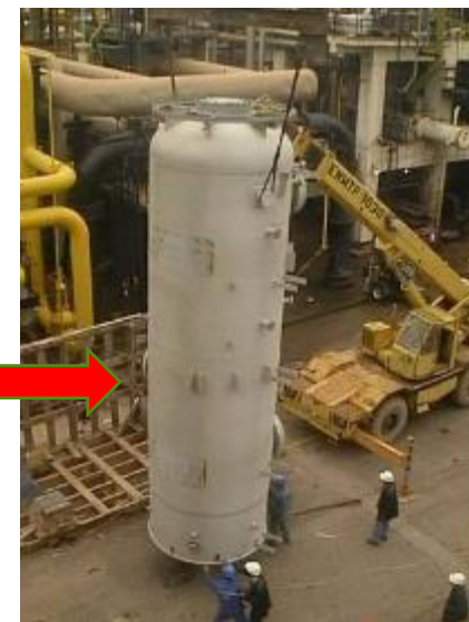
Pall気/液コアレスサー を設置
